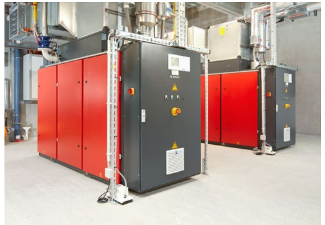
Die Druckluftzentrale ist für die Zukunft erweiterbar.
